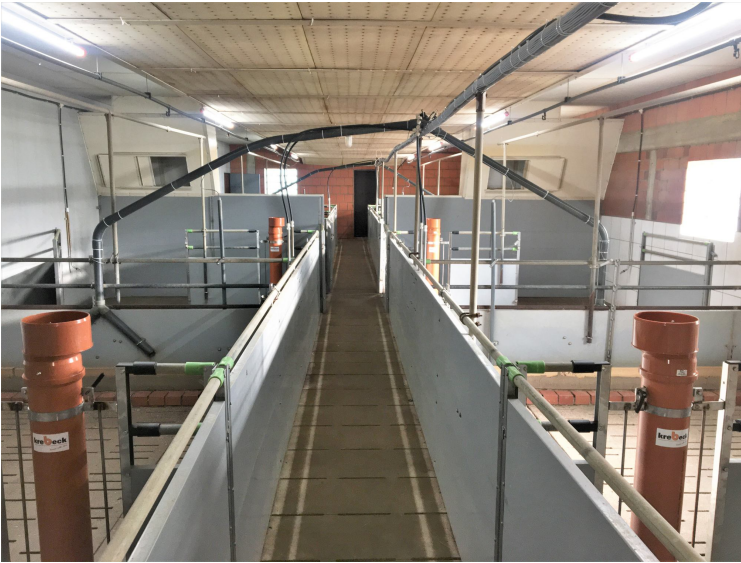
Rohrautomat Stroh an den vorhandenen Trennwänden, Beschickung von Hand
